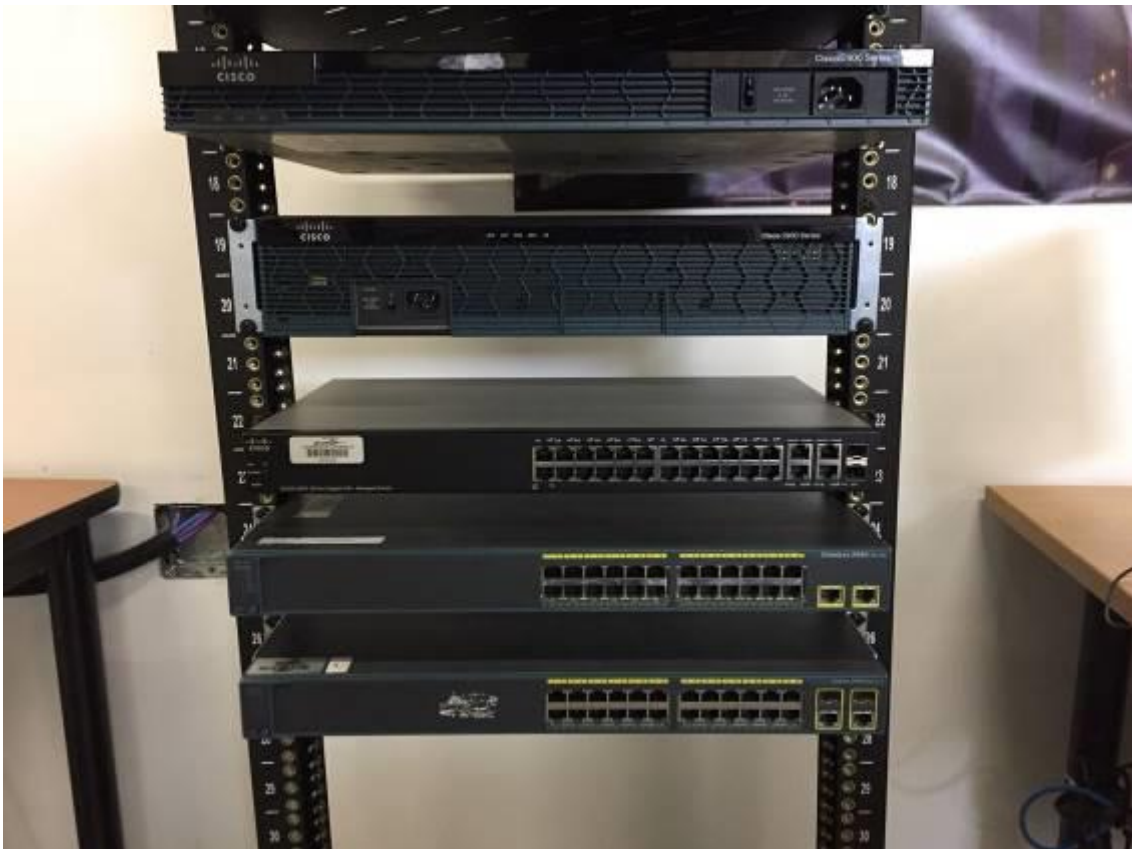
Figura 39. Equipos cisco para configuración local.
