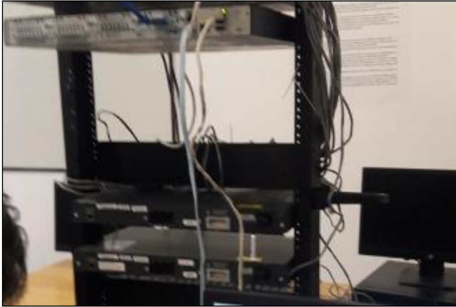
Figura 40. Conexión entre equipos.
