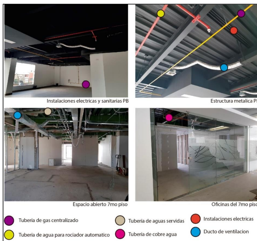
Figura 88. Instalaciones existentes en la edificación
