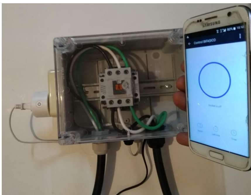
Figura 123. Caja automática de control bifásica apagada.
