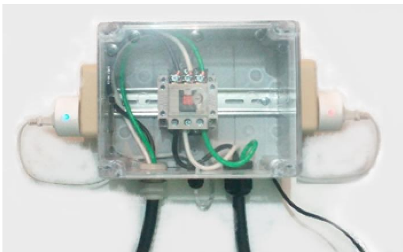
Figura 132. Sistema de automatización y control bifásico y agua potable. (Smart Plug Derecha Agua potable, izquierda Control bifásico)
