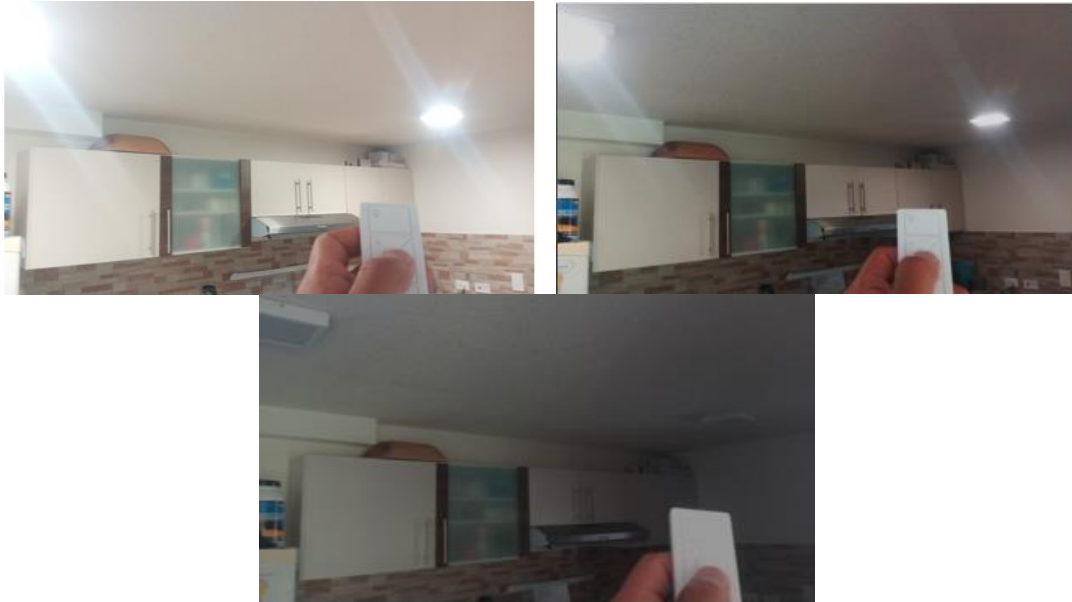
Figura 103. Funcionamiento de las luminarias de la cocina
