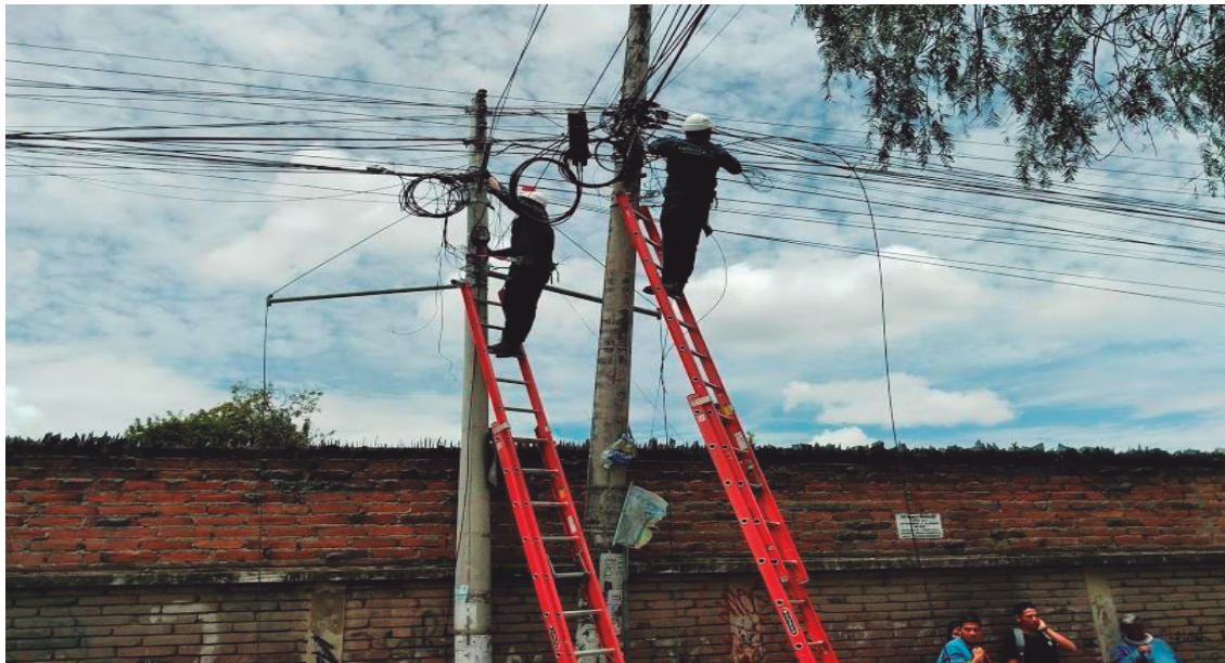
Figura 20. Etiquetado los cables de Puntonet S.A.
