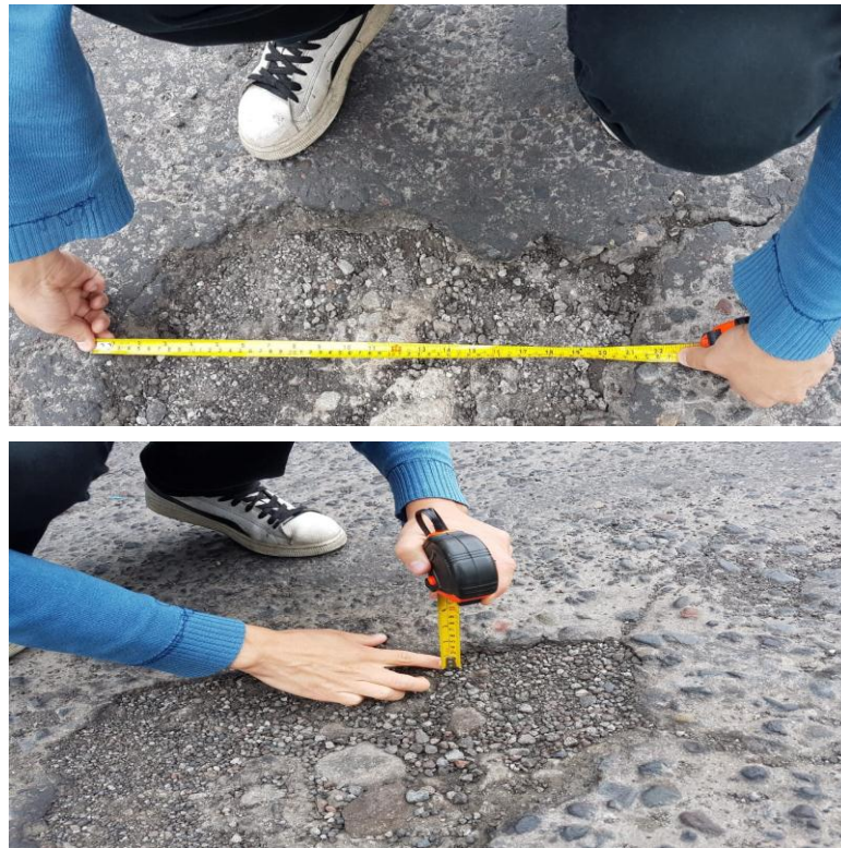
Figura 31. Baches importantes Zona 2
