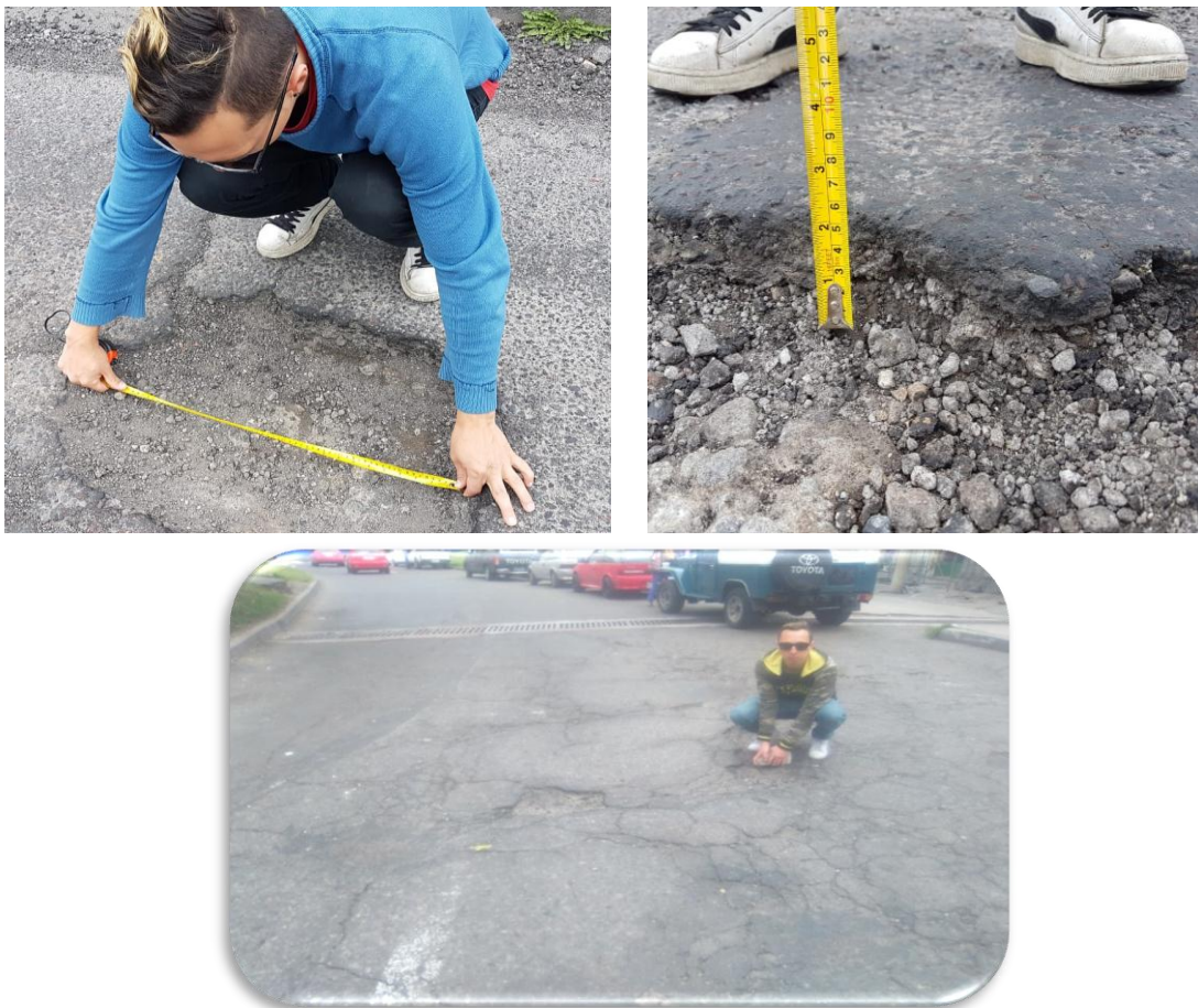
Figura 29. Baches importantes Zona 1
