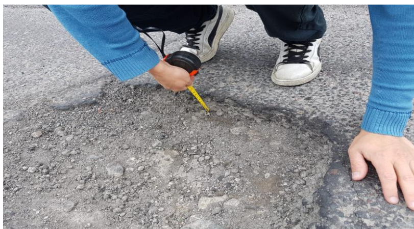
Figura 33. Baches importantes Zona 3
