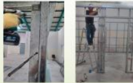
Unión de Paneles con ayuda de pinzas de presión y colocación de tornillos
