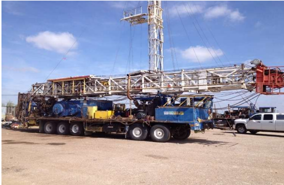
Figura 1. Rig de Reacondicionamiento. Tomado de: Triboilgas 2017.
