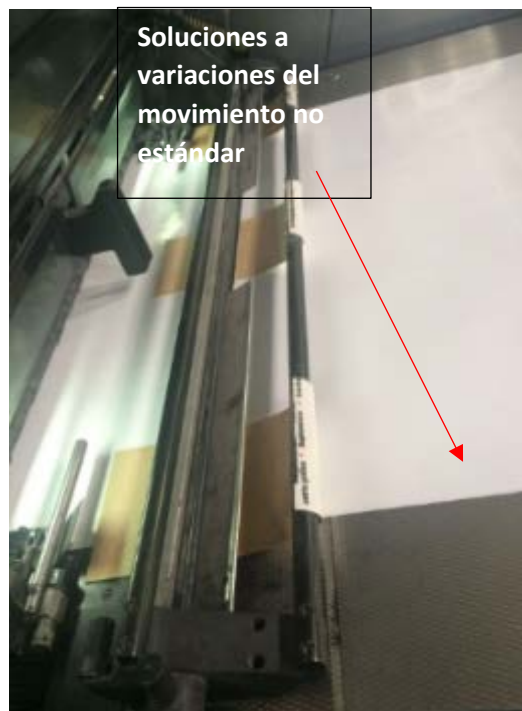
Figura 29. Malas prácticas evidenciadas en el manejo del mantenimiento de Prensas
