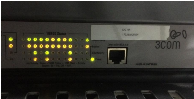
Figura 46 A: Fotografía del Switch 3COM 2426
