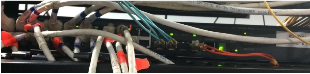
Figura 45 B: Fotografía de la vista frontal Switch HP 5500
