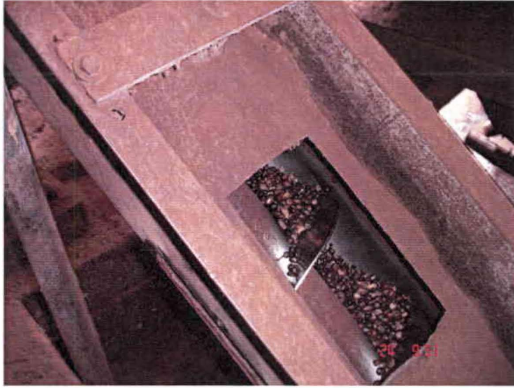
ACERCAMIENTO DE TRANSPORTADOR
