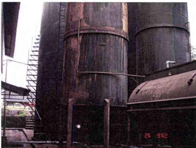
TANQUES DE ALMACENAMIENTO
