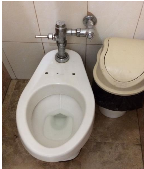
Figura 90. Inodoros del terminal
