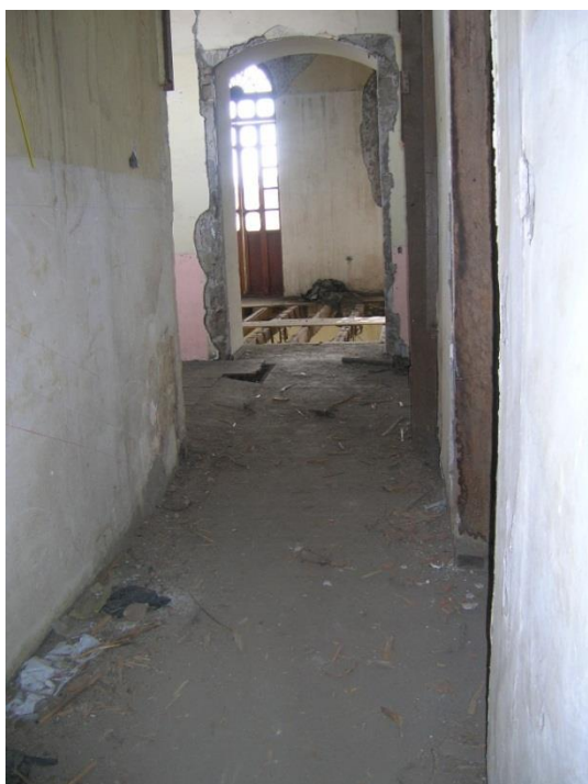
Figura 68. Fotografía interior del Teatro León el deterioro de los pisos y paredes de la edificación
