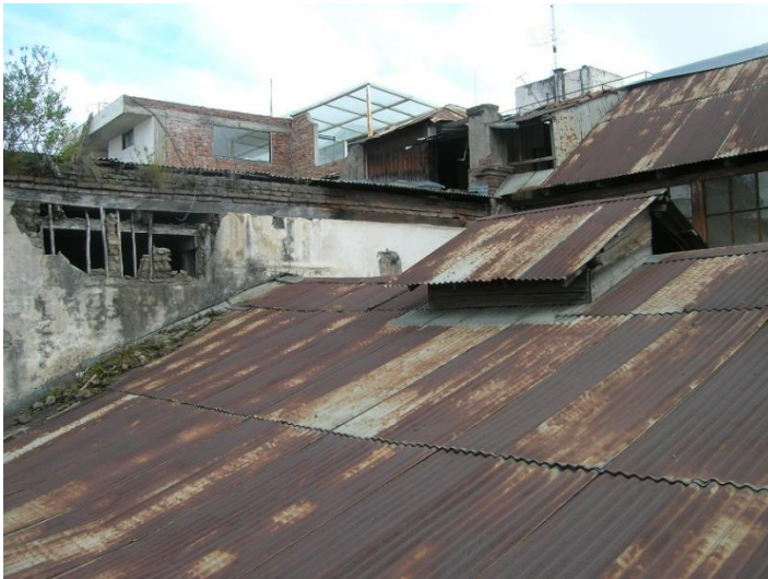
Figura 66. Fotografía del techo provisional que se colocó en la parte superior de la edificación para que no existan filtraciones y de protección a la edificación
