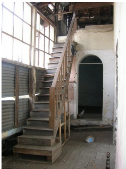
Figura 13. Fotografía interior del Teatro León, Se ha colocado materiales imprevistos para cubrir los daños que se ha generado por el abandono del edificio.
