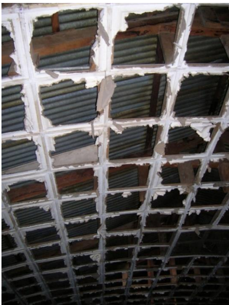
Figura 67. Fotografía del entrepiso del cuarto piso se encuentra en un deterioro completo
