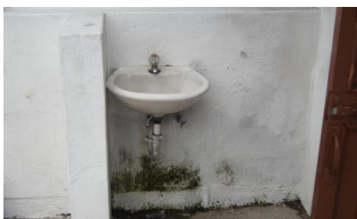
Figura 6. Lavamanos con humedad.
