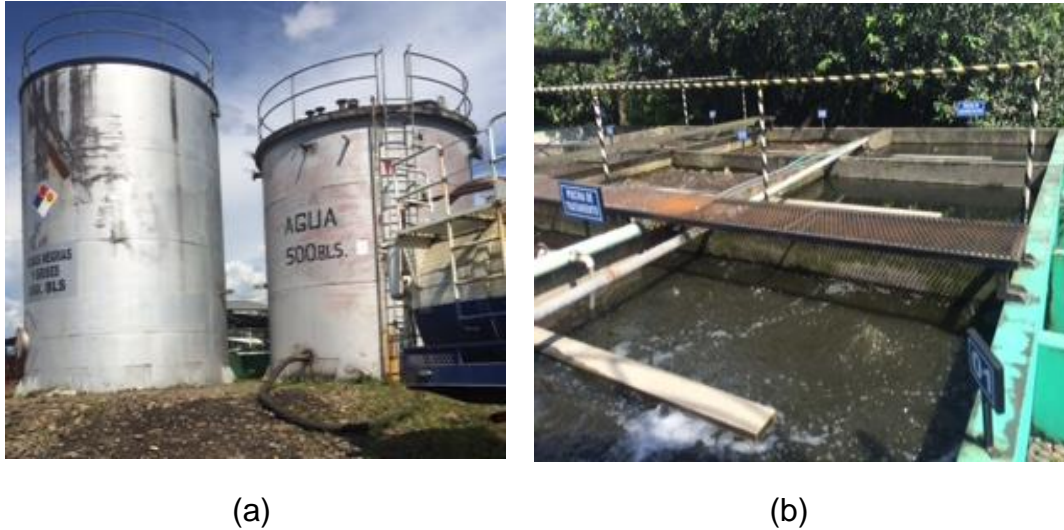
Figura 4. Fotografías de las instalaciones de tratamiento de Vacuumtruck Services S.A.
