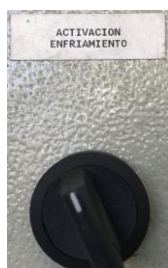
Figura 36. Selector “Activación Enfriamiento”
