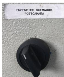
Figura 29. Selector “Encendido Quemador Post-cámara”
