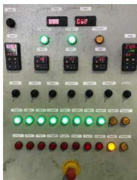
Figura 30. Tablero Eléctrico Encendido
