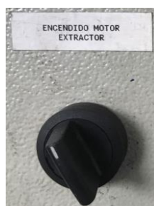
Figura 24. Selector "Encendido Motor Extractor"
