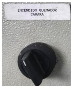
Figura 26. Selector “Encendido Quemador Cámara”
