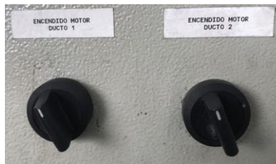
Figura 25. Selectores Encendido Motor Ductos
