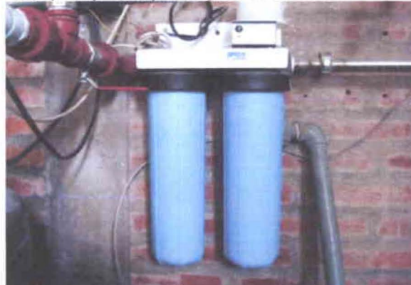
Foto (4.12): Tanque Rayos Ultravioleta
