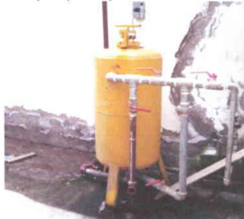
Foto (4.11): Tanque de arena
