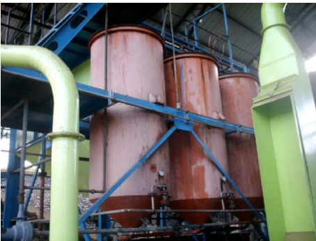
Fotografía #12: Tanques de secado
