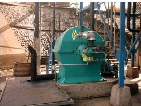
Fotografía # 15: Centrifuga de lodos
