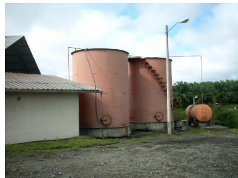
Fotografía #13: Tanques de almacenamiento
