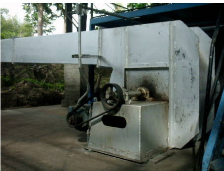
Fotografía # 24: Chimenea de combustión
