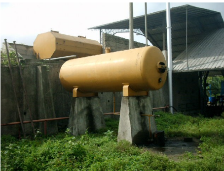
Fotografía # 28: Tanques de combustible
