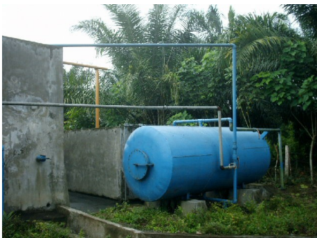
Fotografía # 31: Tanque de agua
