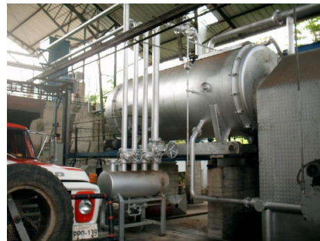
Fotografía # 23: Caldero de vapor
