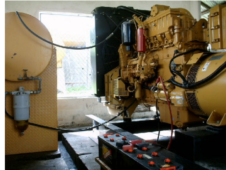
Fotografía # 27: Generador de energía
