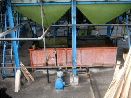
Fotografía # 14: Tanque de lodos
