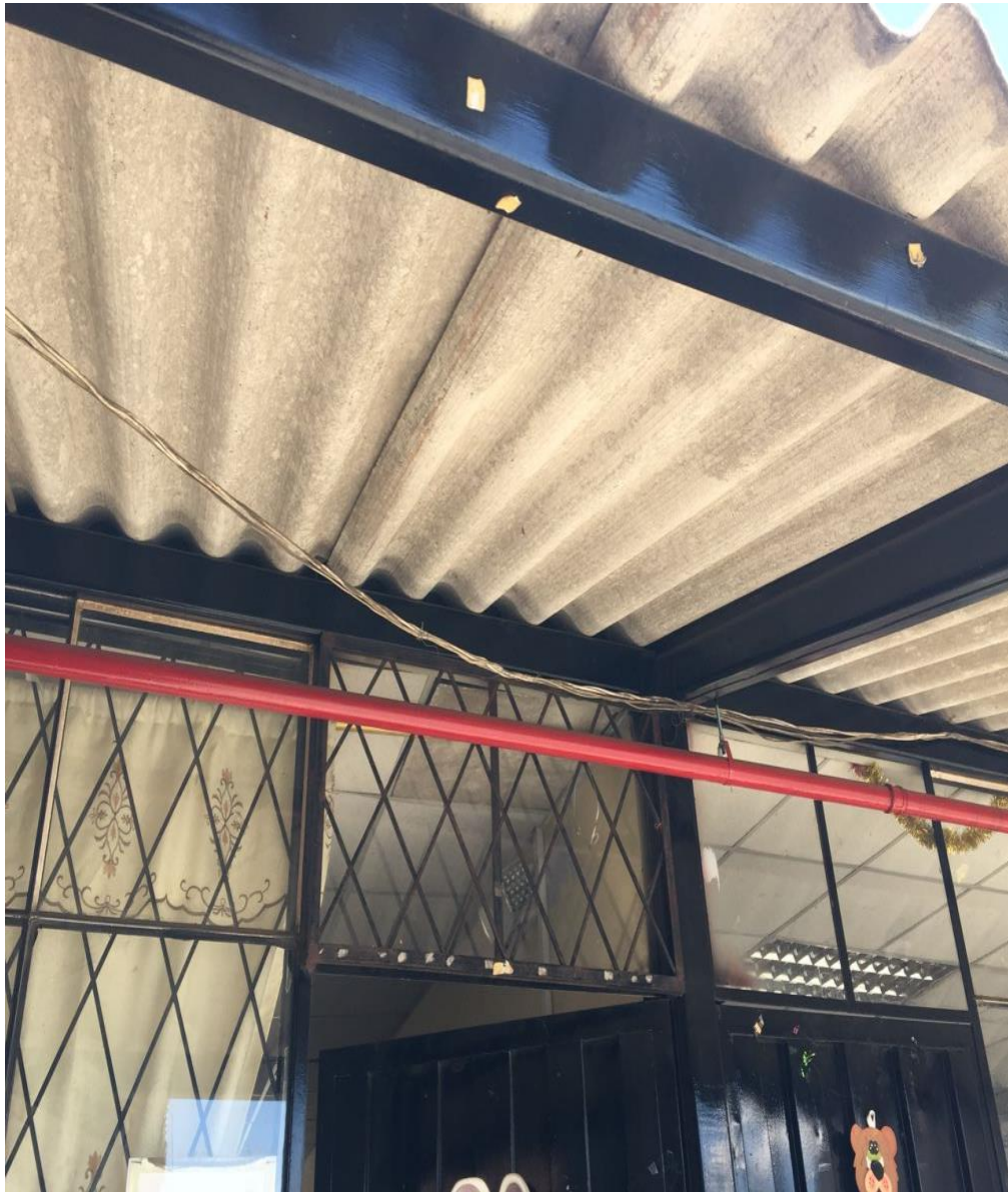
Anexo 11 Cableado mal instalado tumbado
