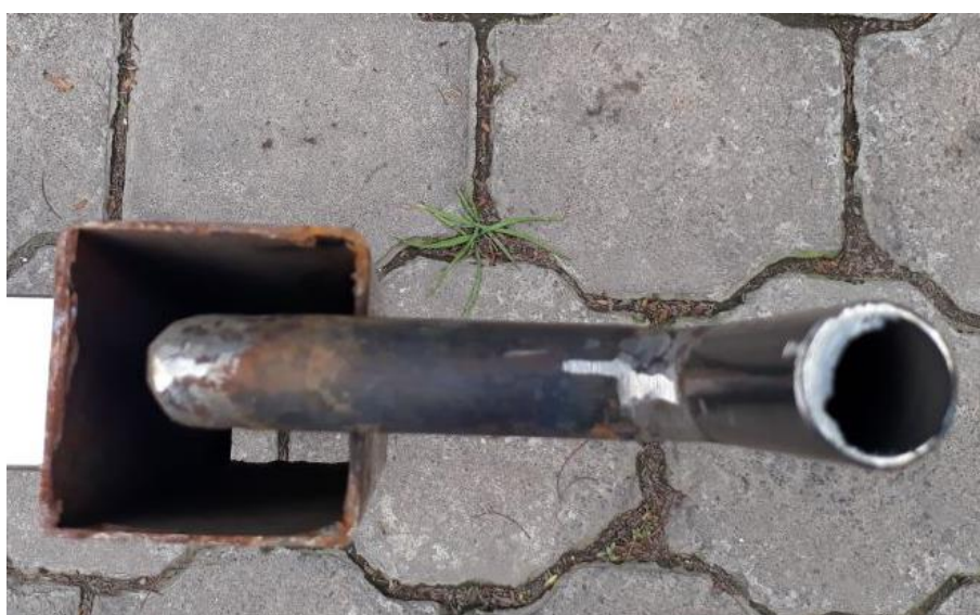
Figura 153. Vista superior tubería – intercambiador de calor.
