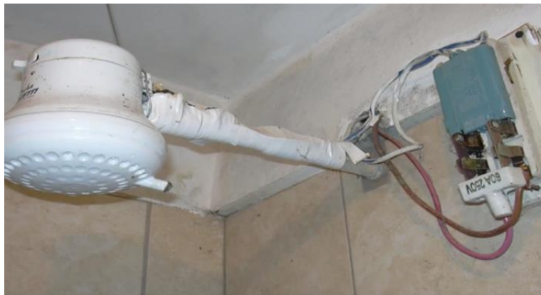
Figura 30. Ducha eléctrica muy cerca de electricidad.
