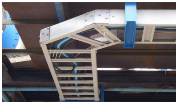
Figura 15. Escalerilla Tomado de (Cisco USA, 2017)
