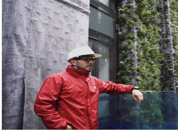
Figura 69: Parte de la fachada del edificio con vegetación y otra en proceso de instalación de la misma.
