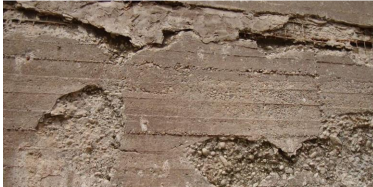
Figura 25. Pérdida de propiedades de los materiales, por efectos de la erosión - Tomado de: La Web (ENCICLOPEDIA BROTO DE PATOLOGÍAS DE LA CONSTRUCCIÓN).
