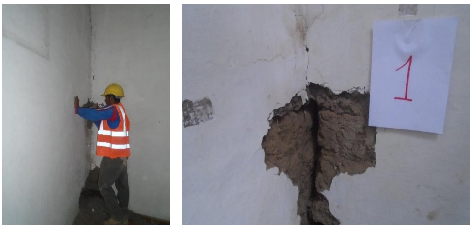
Figura 54. Retiro de enlucidos para verificación de patología (grieta común) Convento Santa Clara - Tomado de: Diego Pichucho.
