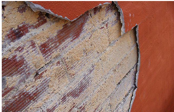
Figura 27. Desprendimiento de enlucidos por la aparición de eflorescencia - Tomado de: La Web (ENCICLOPEDIA BROTO DE PATOLOGÍAS DE LA CONSTRUCCIÓN).
