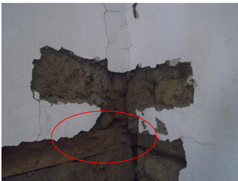
Figura 55. Evidencia de intervenciones antiguas Convento Santa Clara - Tomado de: Diego Pichucho.
