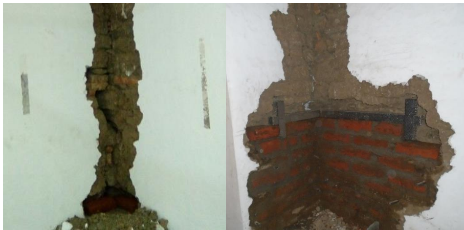
Figura 16. Descosido de mampostería de adobe y cosido de mampostería de ladrillo en Noviciado Santa Clara. (Mampuestos nuevo de ladrillo) - Tomado de: Diego Pichucho.
