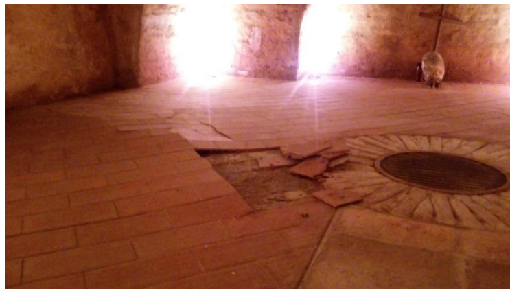
Figura 24. Desprendimiento de revestimiento en pisos en cripta Iglesia Santa Clara - Tomado de: Diego Pichucho.
