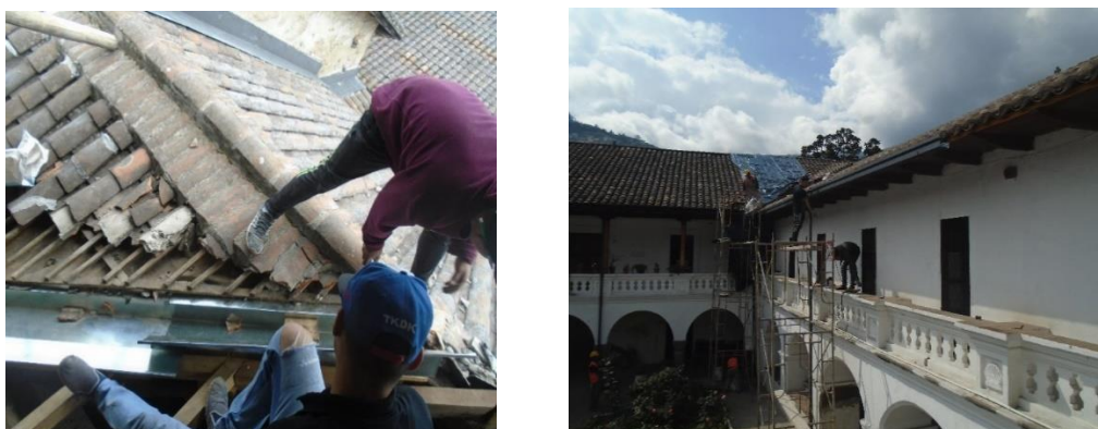
Figura 66. Retiro, mantenimiento y colocación de nuevas piezas para sistema de agua lluvia Convento Santa Clara - Tomado de: Diego Pichucho.
