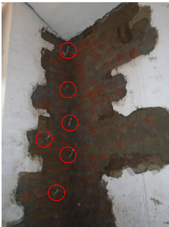
Figura 58. Colocación de manguerillas en cosido de mampostería de ladrillo Convento Santa Clara - Tomado de: Diego Pichucho.
