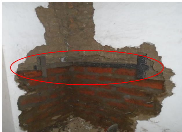
Figura 60. Llaves de madera de colorado de 7x7 sobre cosido Convento Santa Clara - Tomado de: Diego Pichucho.
