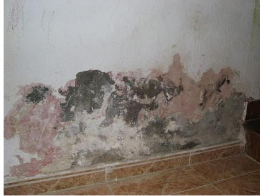
Figura 26. Aparicio de eflorescencia superficial en muros - Tomado de: La Web (ENCICLOPEDIA BROTO DE PATOLOGÍAS DE LA CONSTRUCCIÓN).
