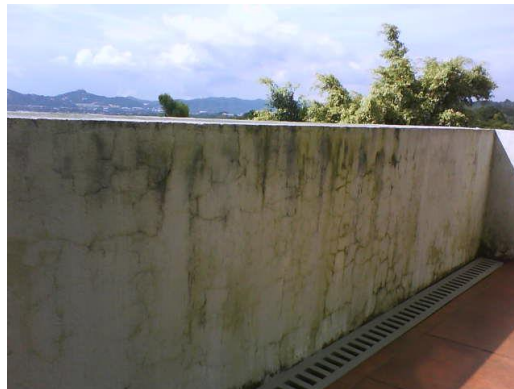
Figura 30. Daño a edificaciones por aparición de humedad y vegetales - Tomado de: La Web (ENCICLOPEDIA BROTO DE PATOLOGÍAS DE LA CONSTRUCCIÓN).
