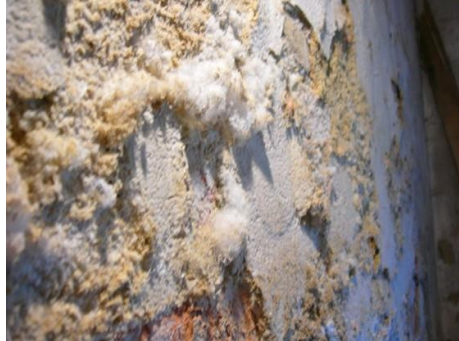
Figura 28. Criptoflorescencias en paredes - Tomado de: La Web (ENCICLOPEDIA BROTO DE PATOLOGÍAS DE LA CONSTRUCCIÓN).
