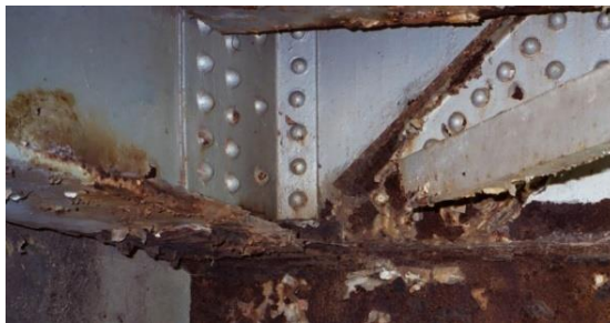
Figura 29. Lesión química en elementos estructurales metálicos - Tomado de: La Web (ENCICLOPEDIA BROTO DE PATOLOGÍAS DE LA CONSTRUCCIÓN).
