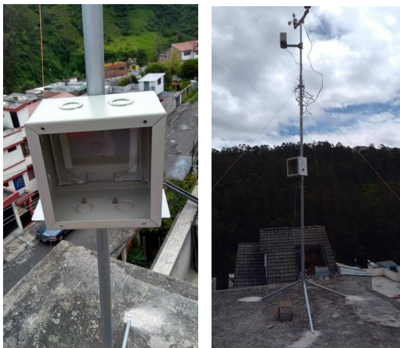
Figura 91. Fijación gabinete para los equipos activos.
