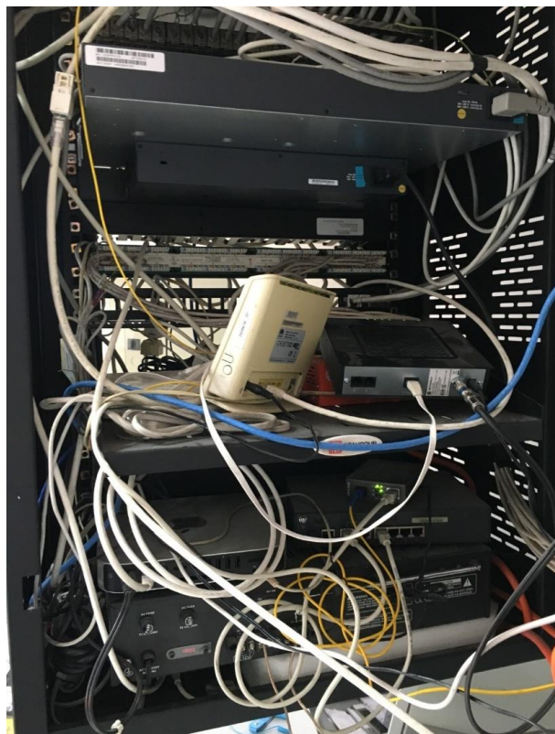
Figura 15. Rack abierto vista posterior
