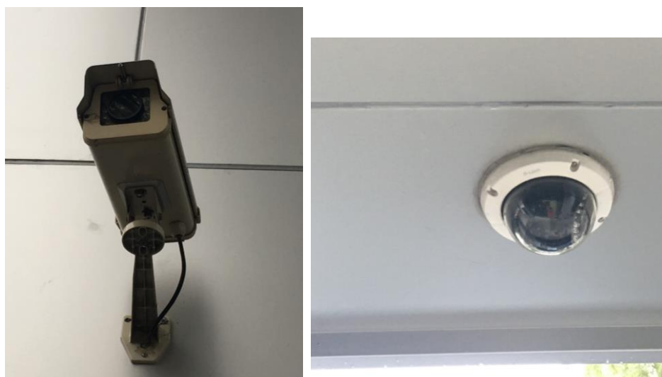
Figura 46. Implementación de Cámaras IP para el exterior del edificio.
