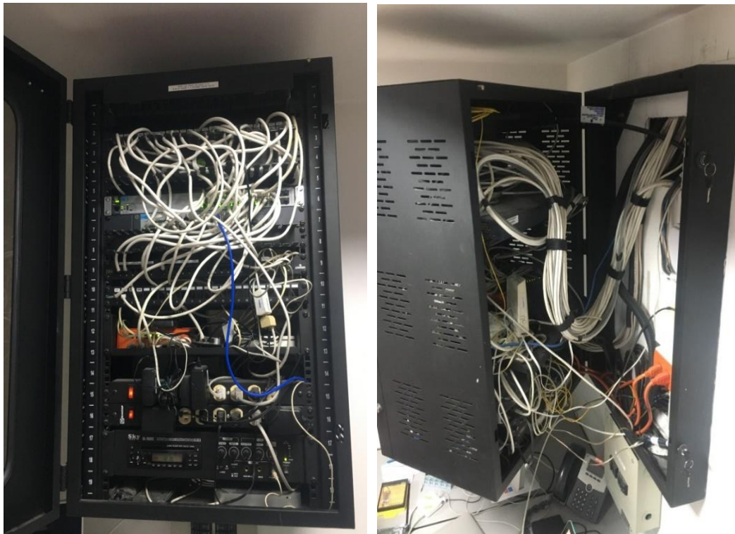
Figura 14. Rack Abierto, parte frontal (izquierda) y posterior (derecha).
