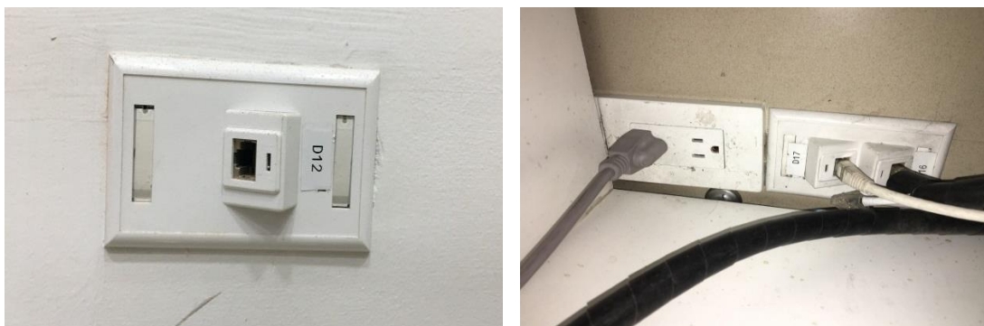
Figura 17. Face Plates fijos de pared, baldosa.
