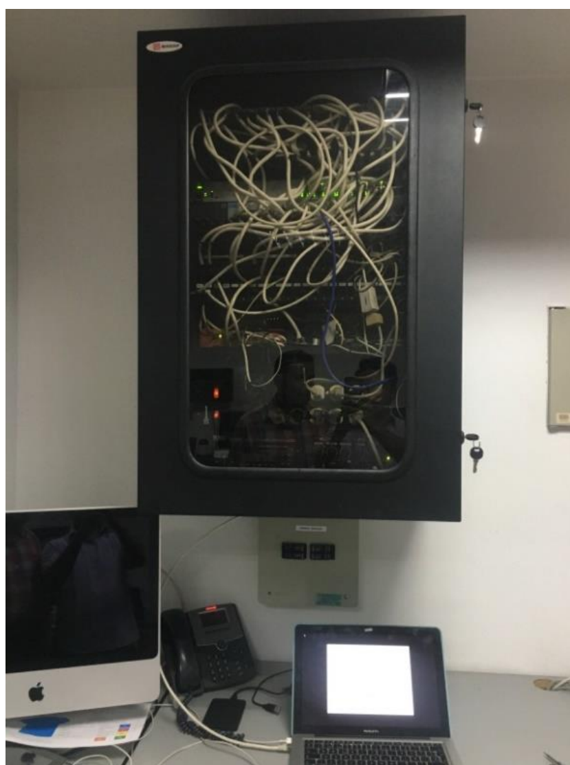
Figura 13. Rack de Telecomunicaciones
