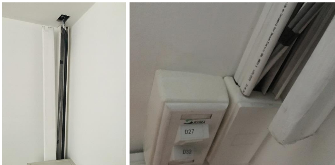
Figura 16. Cableado Cat. 5e con canaleta y cajetín
