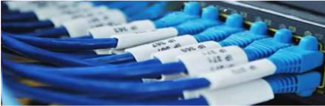
Figura 38. Etiquetado del cableado estructurado.
