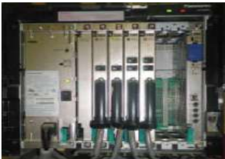
Figura 17. Central telefónica KX-TDA-100
