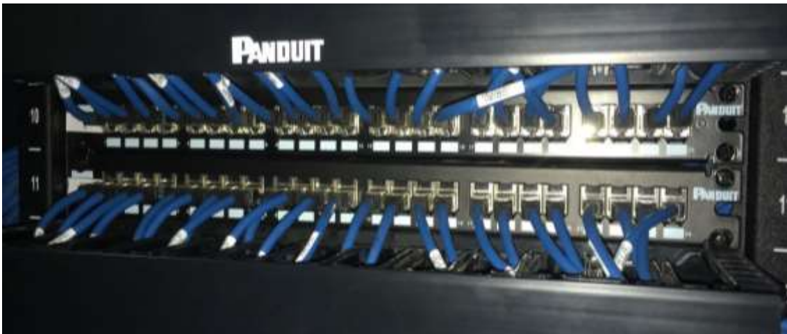
Figura 36. Implementación Patch Panel y Jacks.
