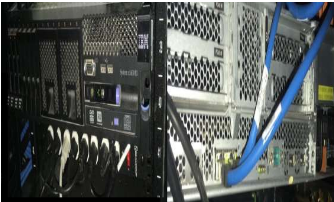
Figura 40. Instalación del servidor en el rack del data center .
