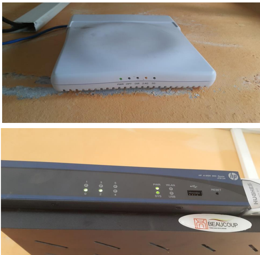
Figura 35. Equipos de comunicación Totoras
