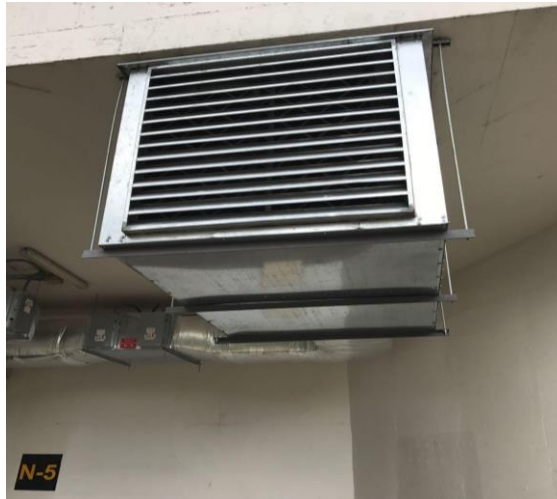
Figura 30. Sistema de climatización
