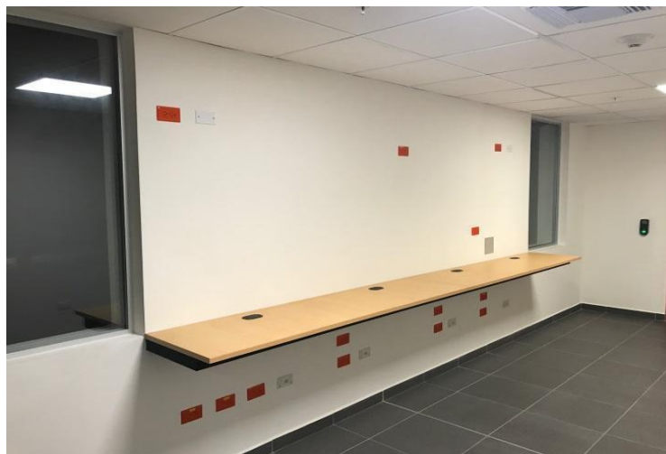
Figura 24. Ubicación de las tomas eléctricas, cuarto de control.
