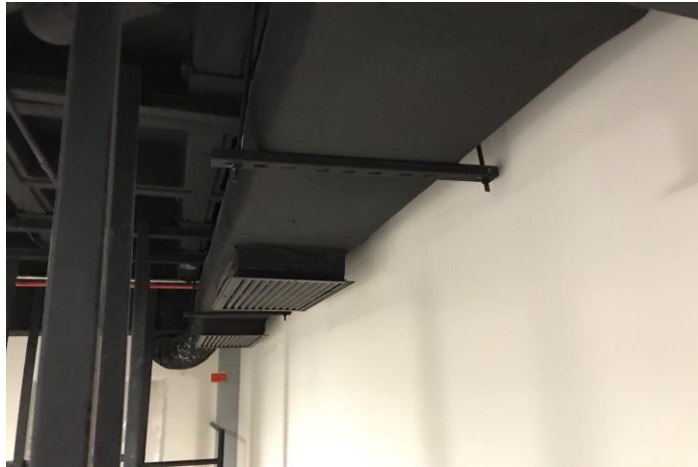
Figura 28. Sistema de ventilación interior del estudio de televisión
