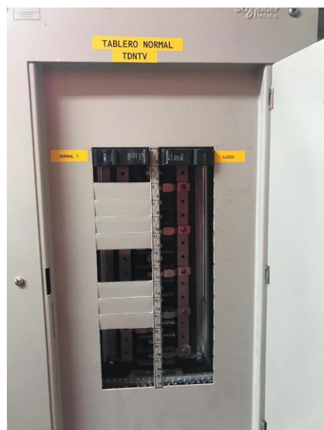
Figura 25. Tablero para iluminación
