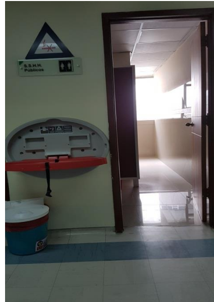
Instalación sanitaria de Pediatría
