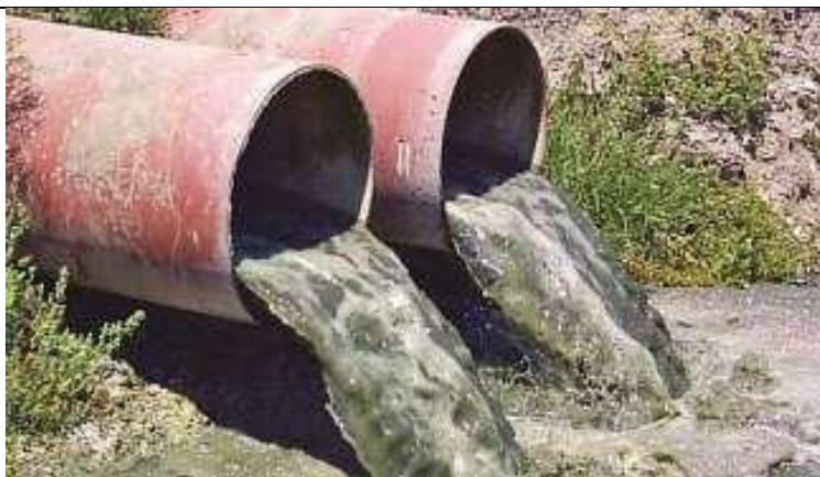
Figura N° 4: Descarga de aguas servidas
