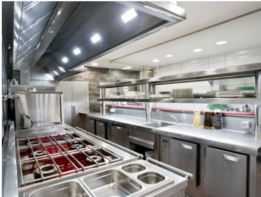
Figura 18. Iluminación en Cocinas
