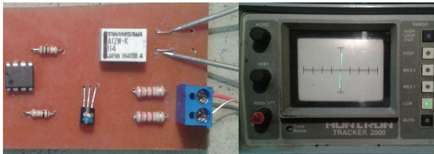
Figura 47. Cortocircuito entregado por los contactos N/A de Relay 1
