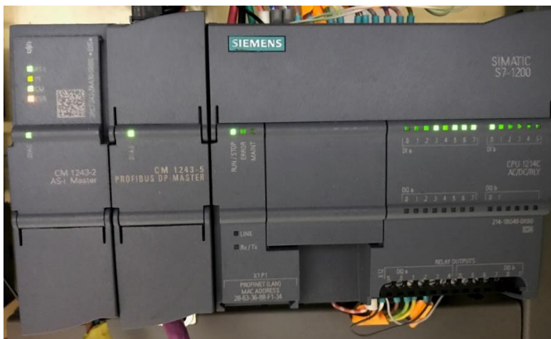
Figura 68. PLC S7-1200 con indicadores correctos para su funcionamiento.
