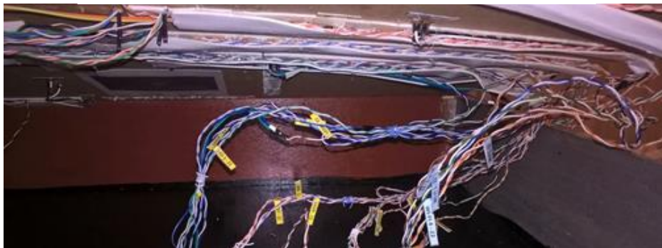
Figura 56. Cableado y etiquetado sobre la maqueta.
