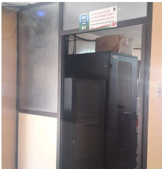
Figura 21. Racks principales de equipos GAD Guamote oficina TI.
