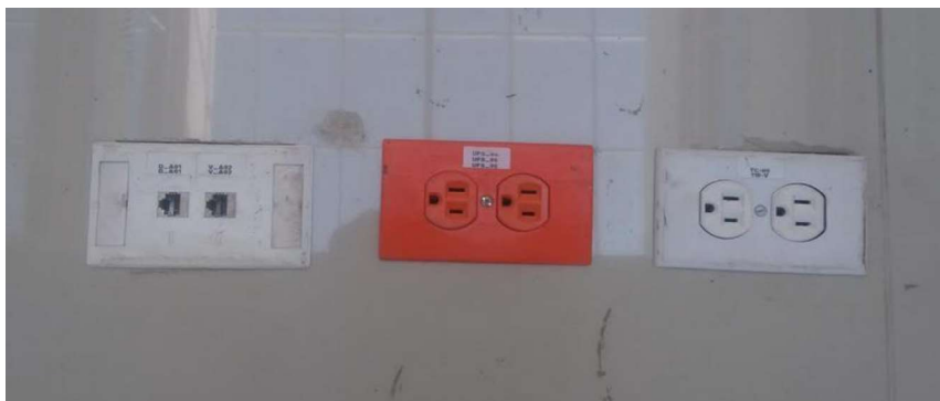
Figura 30. Etiquetado puntos de red y eléctricos del GAD de Colta.
