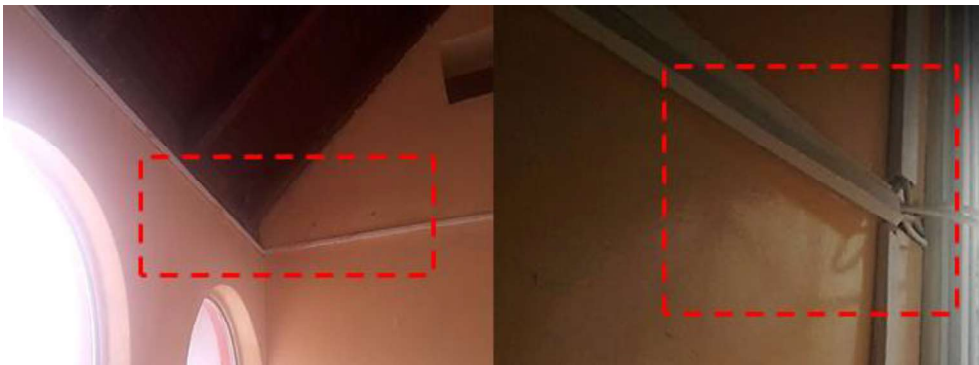
Figura 25. Cableado horizontal con canaletas GAD Guamote
