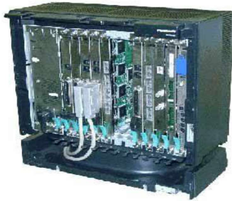
Figura 43. Central telefónica KXTDA-100
