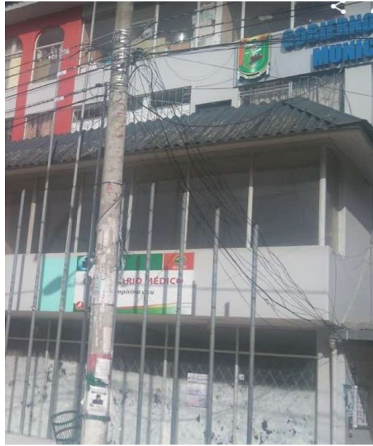
Figura 34. Ingreso de líneas telefónicas GAD Guamote.
