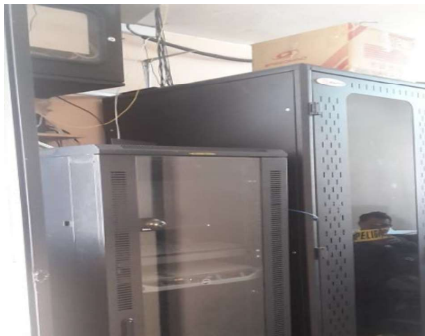
Figura 19. Racks de comunicaciones GAD Guamote.
