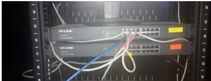
Figura 23. Conexiones rack principal para las áreas GAD Guamote
