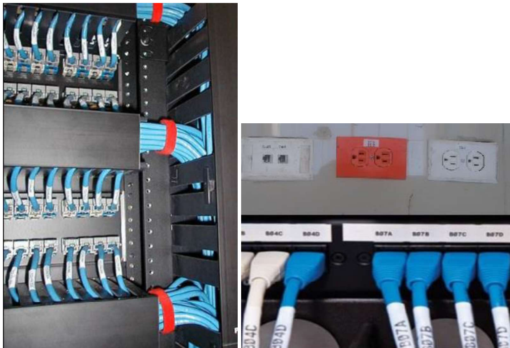
Figura 48. Etiquetado de equipos.
