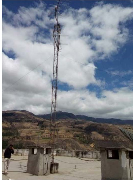
Figura 31. Torres ubicada en la azotea del GAD
