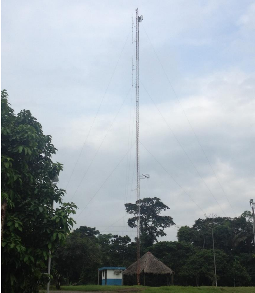
Figura 61. Torre de telecomunicaciones de la estación Yuca Central.
