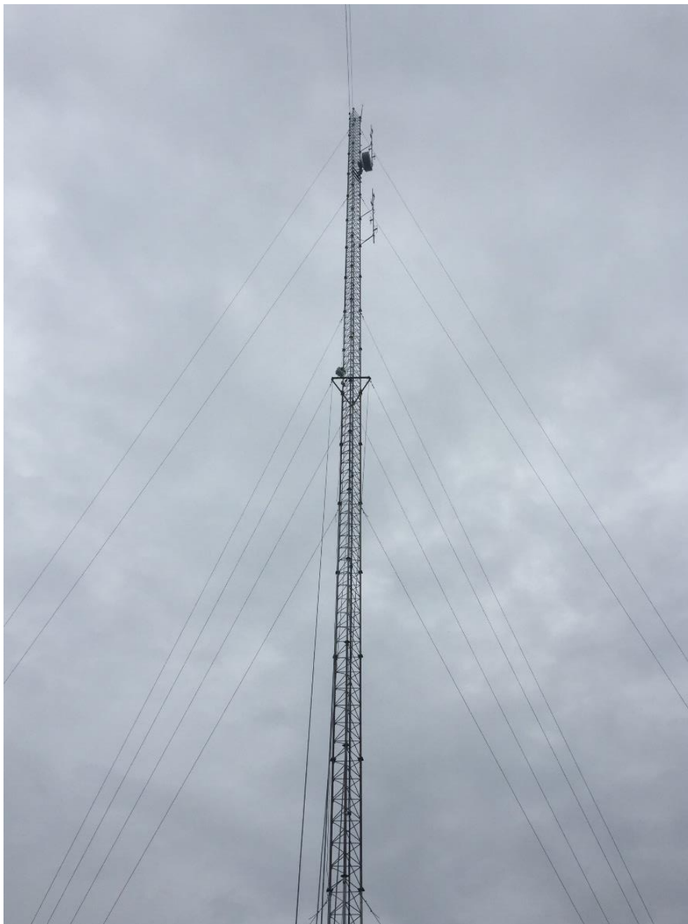
Figura 69. Torre de telecomunicaciones de la estación Cononaco.
