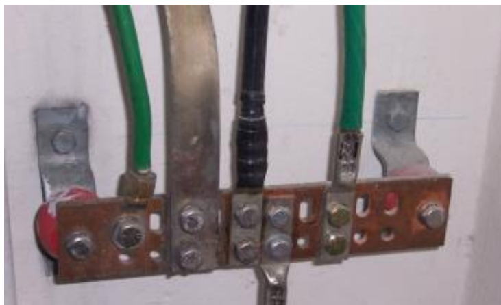
Figura 32. Barra TMGB instalada en un cuarto de telecomunicaciones.
