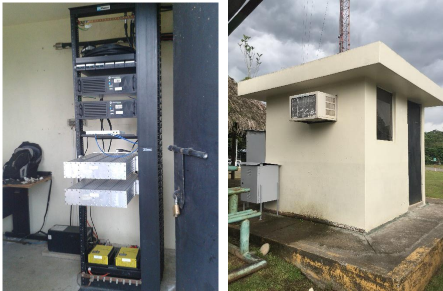
Figura 62. Caseta de telecomunicaciones de la estación Yuca Central.
