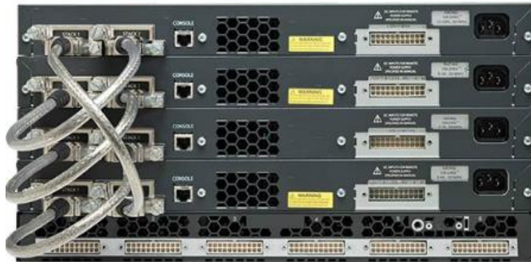
Figura 38. Switches Cisco de configuración apilable.
