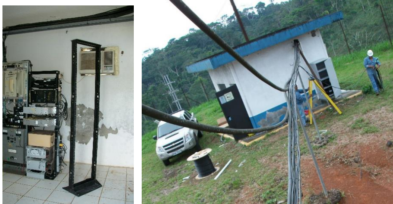
Figura 70. Caseta de telecomunicaciones en la estación Cononaco.
