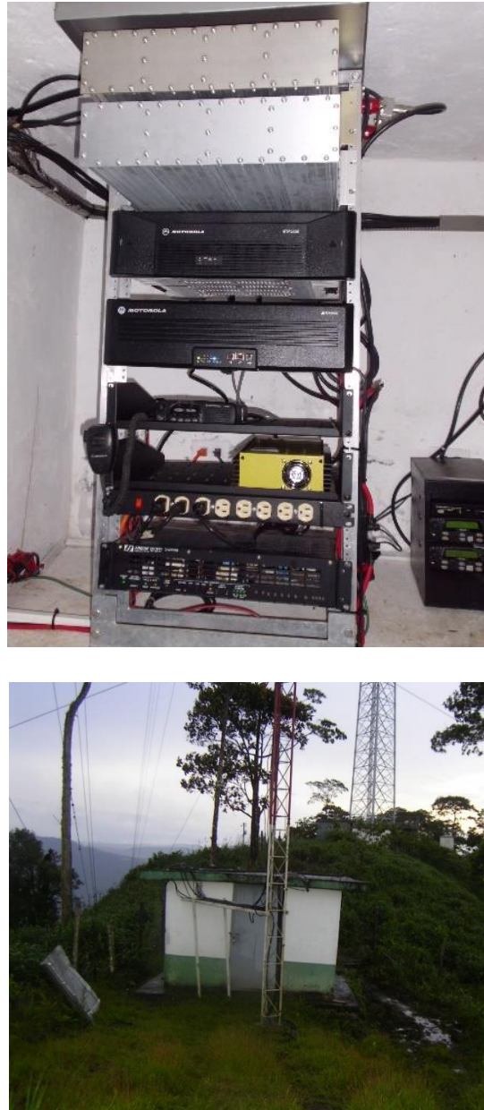
Figura 74. Caseta y equipos en el cerro Lumbaqui.
