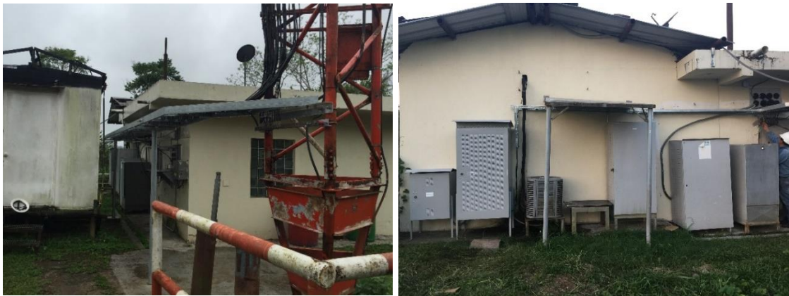
Figura 66. Cuarto de equipos y gabinetes en el del Auca Central.
