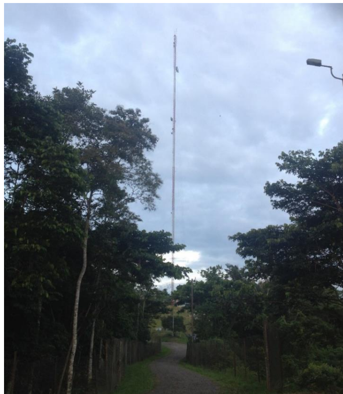
Figura 65. Torre de telecomunicaciones de la estación Auca Central.
