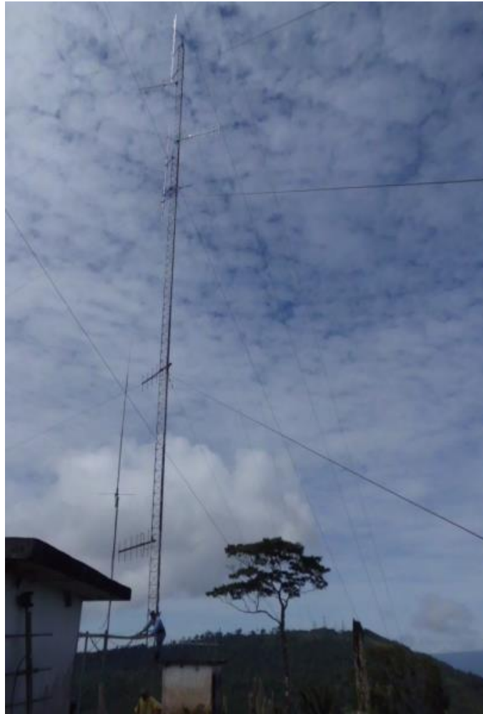
Figura 73. Torre de telecomunicaciones ubicada en el cerro Lumbaqui.
