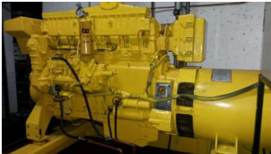
Figura 13. Generador Caterpillar Hotel Sheraton
