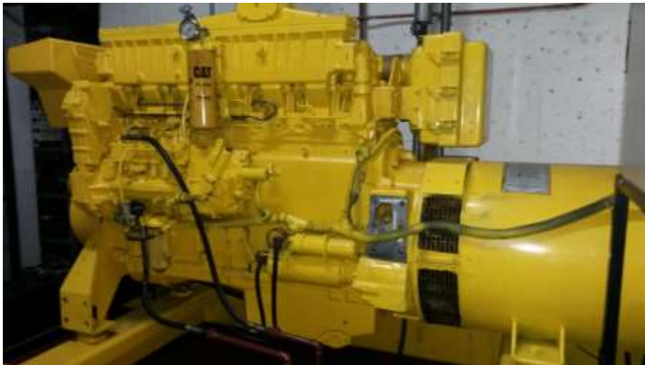
Figura 13. Generador Caterpillar Hotel Sheraton
