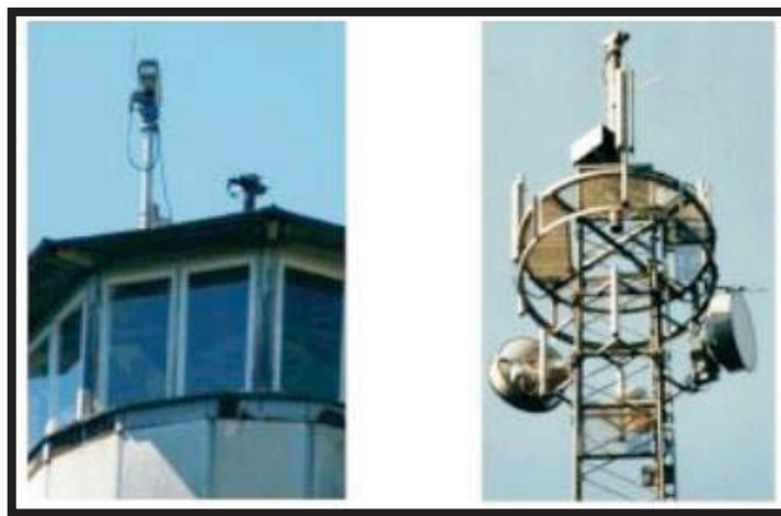
Figura 26. Torres de detección de incendios.
