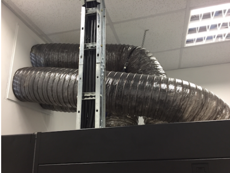
Figura Componente Sistema de ventilación
