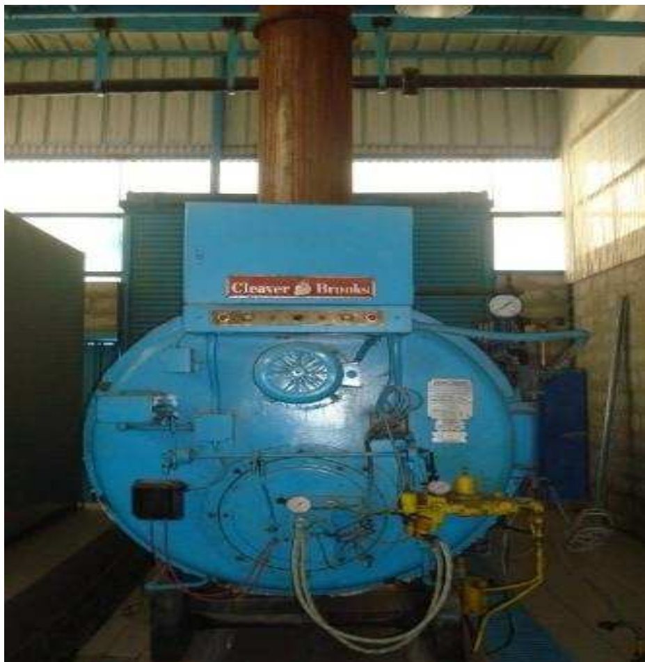
Fotografía No. III.9. Caldero Cleaver Brokks
