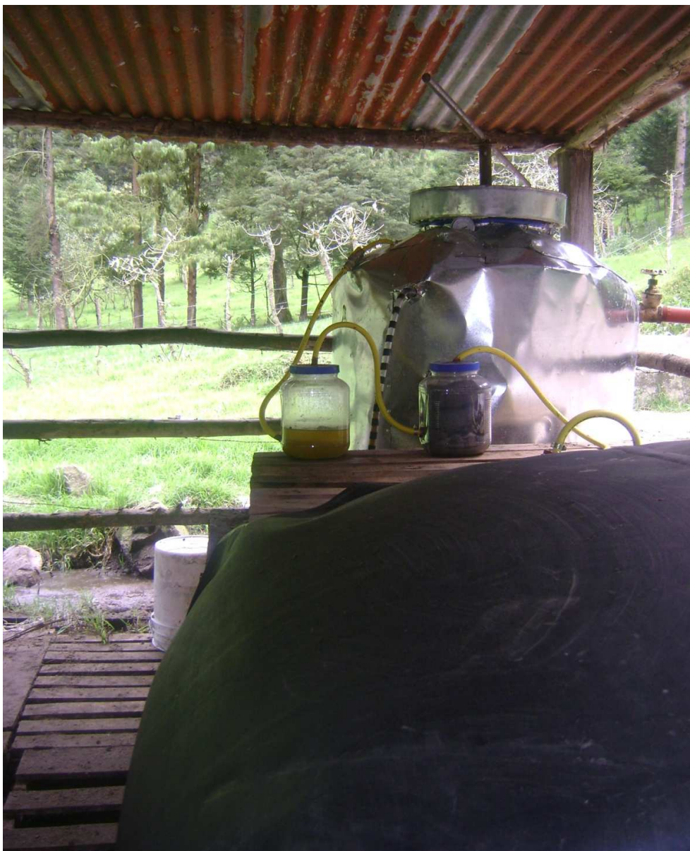
Fotografía N° 6.1: Bio-digestor terminado y en funcionamiento en la Hacienda San Juan
