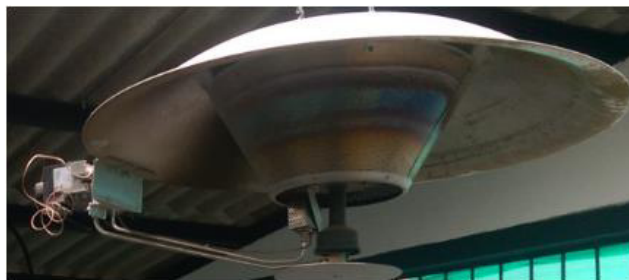
Figura 13. Calefactores a Gas
