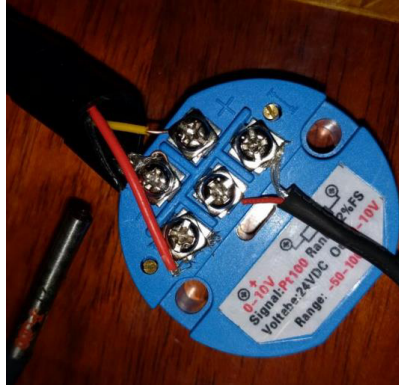
Figura 52. Conexión de sensor a acondicionador
