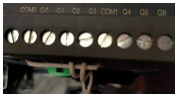
Figura 57. Salidas Equipos de Control
