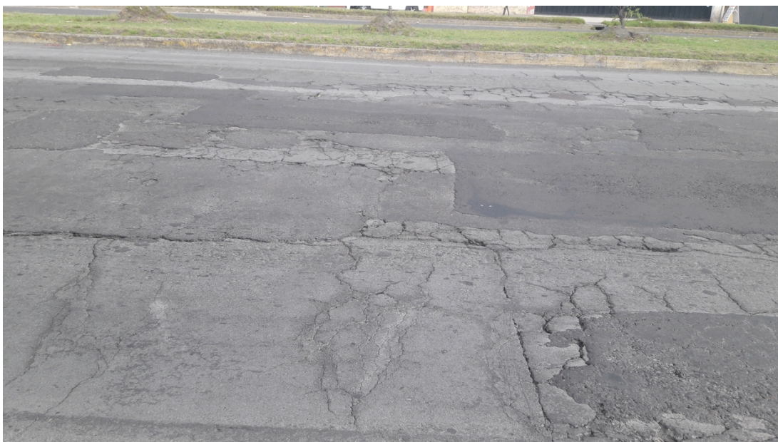
Figura 24. Calzada deteriorada del punto de medición “Panamericana Norte”.
