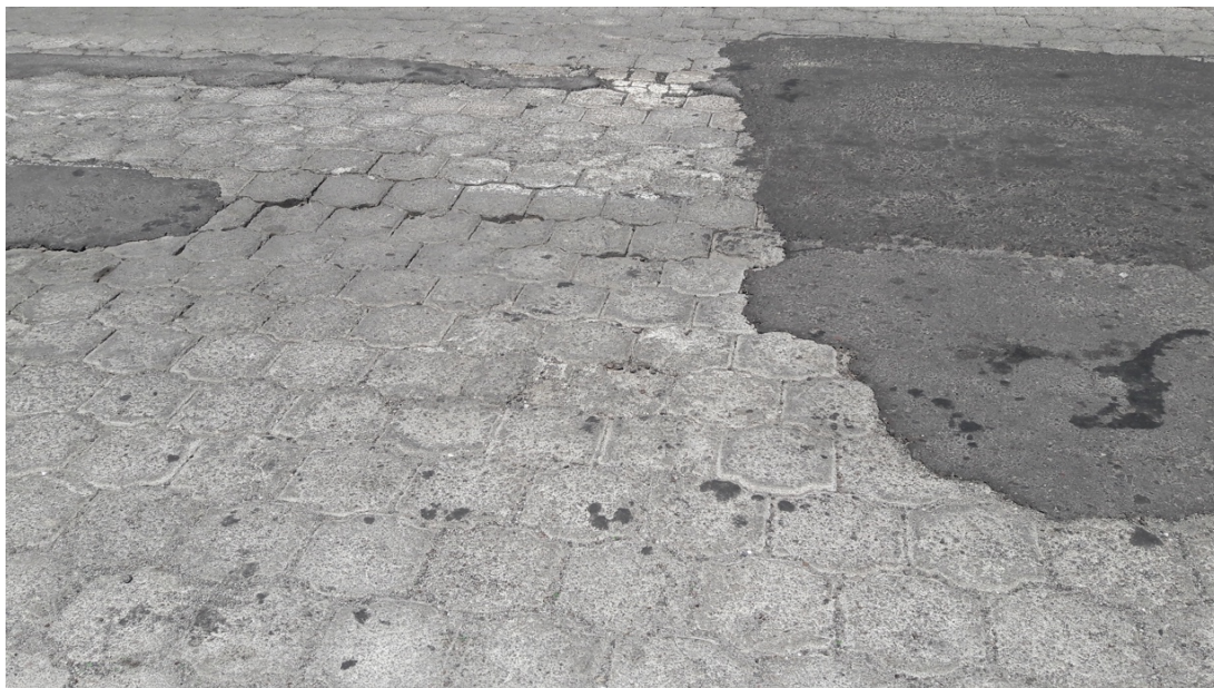
Figura 23. Calzada deteriorada del punto de medición “De Los Colimes”.
