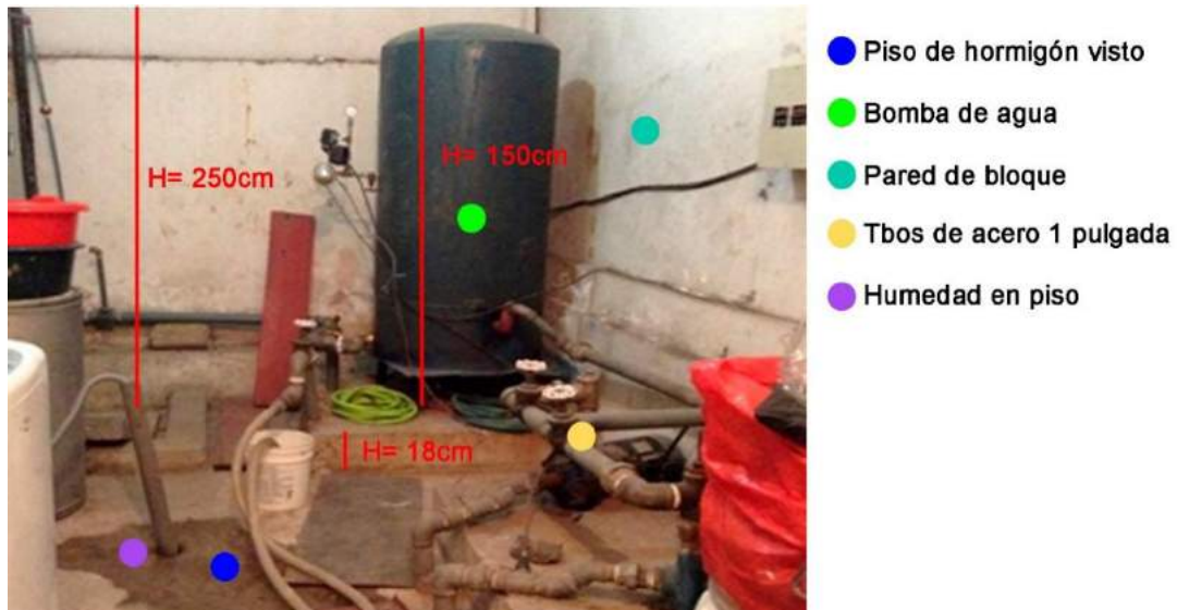
Figura 70. Área de Bombas y distribución de agua de la Plaza de Toros Belmonte.
