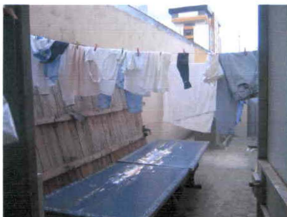
Lavandería del conserje: mesas en proceso de deterioro
