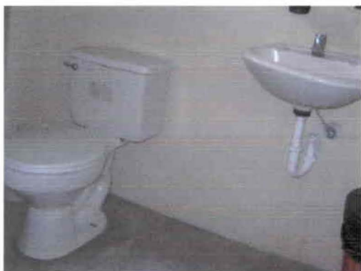
Baño sin acabados en piso ni paredes
