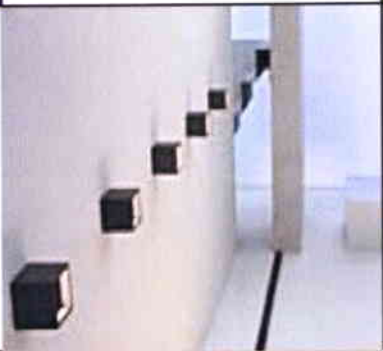
Plafones cuadrados instalados en el cielo raso del pasillo de oficinas.
