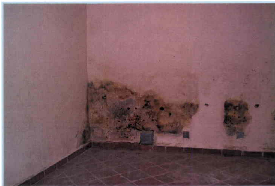
Fotografía N° 36 – Humedad en los muros portantes del subsuelo
