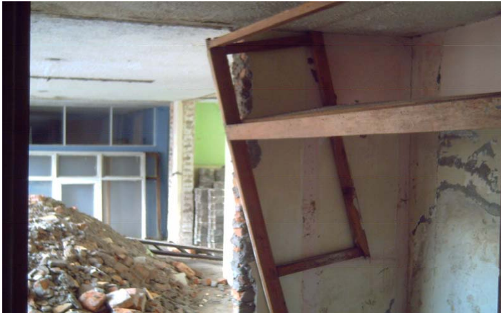
Img. 4.40, Estado actual de la mampostería de la tercera planta alta.
