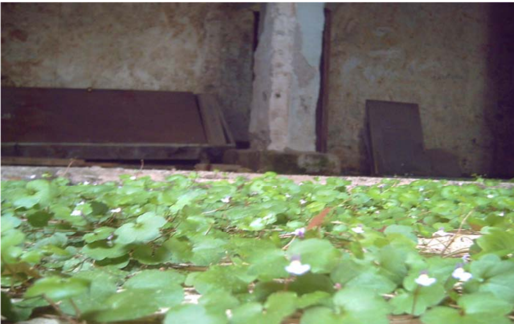
Img. 4.23, Estado actual del piso en planta baja.
