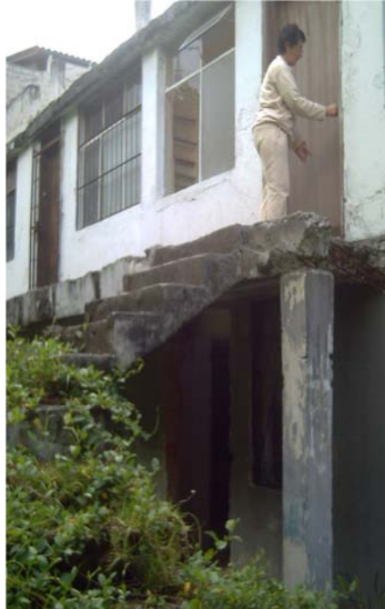
Img. 4.36, Escaleras traseras exteriores, que llevan de la segunda planta exterior a la tercera planta alta.
