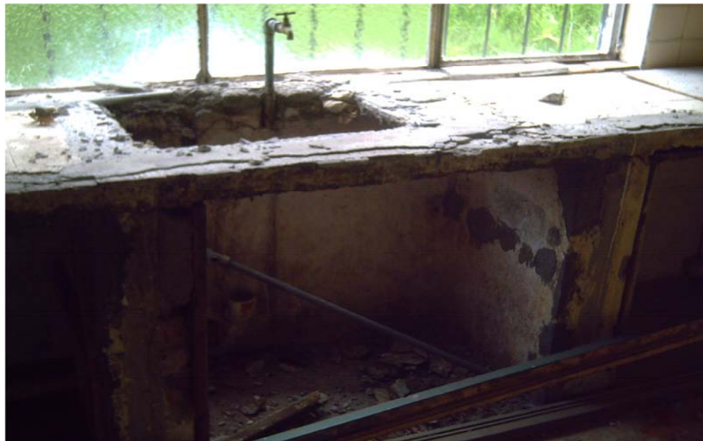
Img. 4.41, Estado actual de mampostería e instalaciones de la tercera planta alta.
