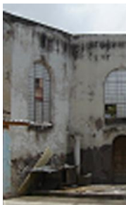
Imagen 3.66 Existen daños en las paredes expuestas de la nave norte
