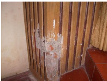
Imagen 3.63 Columnas carcomidas y en muy mal estado
