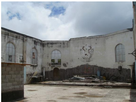
Imagen 3.67 Carece de techo y tiene piso de homigon.
