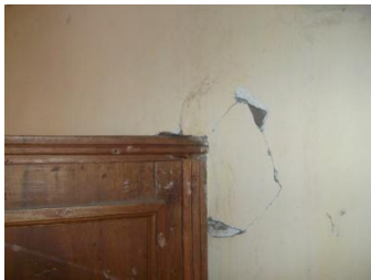
Imagen 3.62 Rajaduras en el estucado y pintura de recubrimiento
