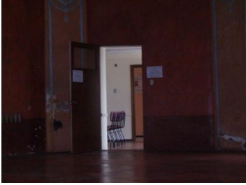
Imagen 3.64 Las paredes en mal estado por la humedad
