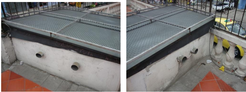
Imagen 3.46 Y 3.47 Caja de ventilación
