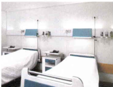
FOTO 2.2. Iluminación en habitaciones
